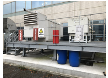
非常用発電機 高上げ(RTC)
