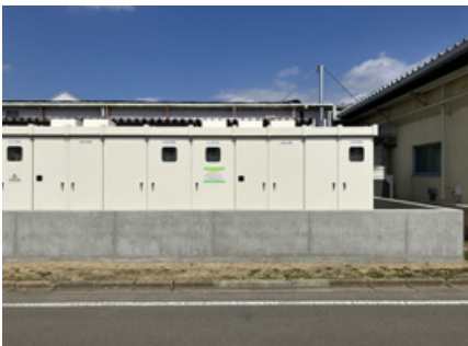
高圧受電設備 擁壁化(RI東北)
