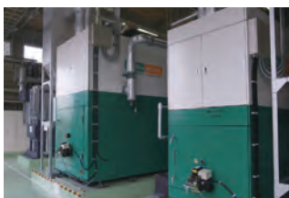
木質バイオマスボイラー
