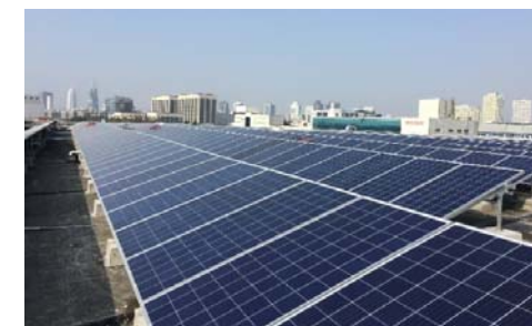
上海開発拠点の太陽光パネル
