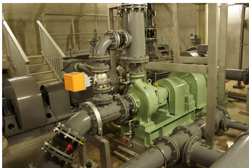
東部地域広域水道企業団施設内に導入されたマイクロ水力発電システム
