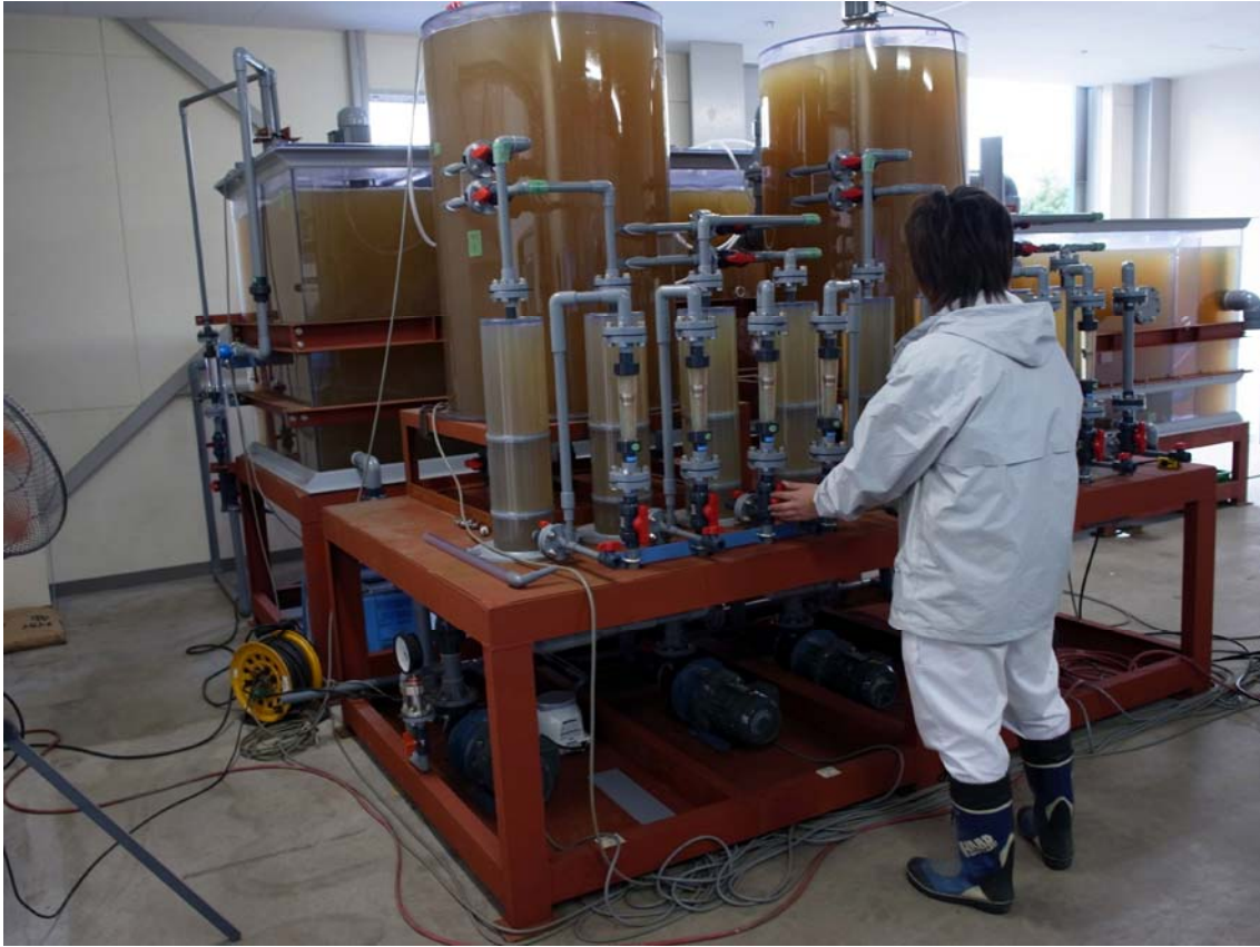
次世代用水処理設備（一部）
