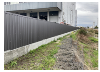
防水壁設置事例R沼津事業所
