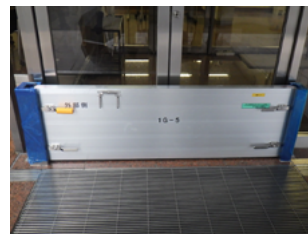
止水板設置事例R池田事業所
