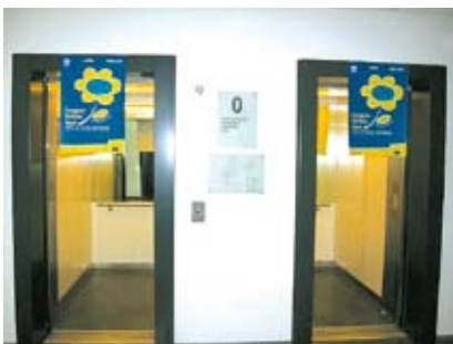
停止中のエレベーター
