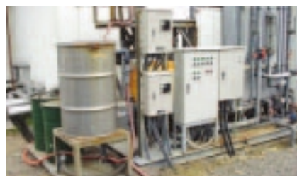
リコーエレメックス恵那事業所の地下水質浄化施設
