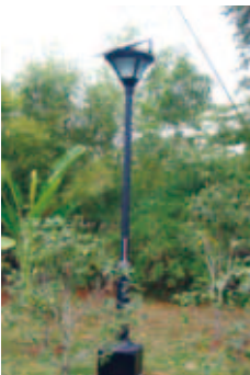
公園に設置された太陽光充電型LED街灯
