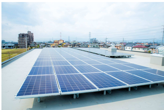
屋上に設置した太陽光電池モジュール
